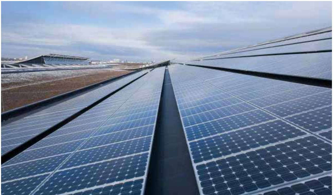
Toit solaire de la nouvelle foire de Stuttgart: un des plus grands ensembles de panneaux photovoltaïques au monde.
